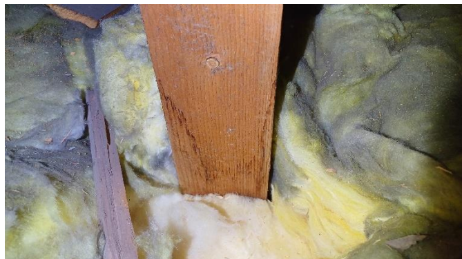
Kuva 4 Viuhkamaisia kosteusvauriojälkiä puurakenteissa
